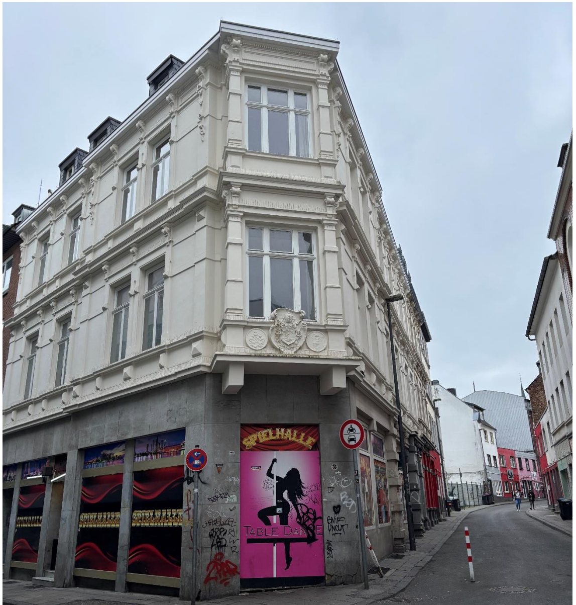
Abbildung 35: Gebäude mit unterschiedlichen Erhaltungszuständen der Fassade im Erdgeschoss und in den Obergeschossen (Quelle: NRW.URBAN, Aufnahme April 2025)
