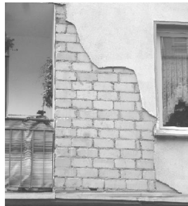
Putzschaden an einer Hausfassade
