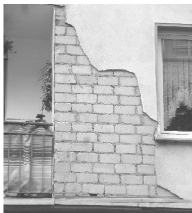
Putzschaden an einer Hausfassade
