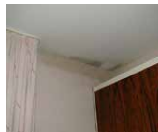
Schimmelfall im oberen Eckbereich eines Zimmers
