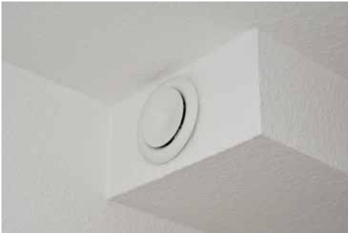
Abluftöffnung (Abführen „verbrauchter“ Luft) bei einer nachträglich eingebauten, zentralen Lüftungsanlage
