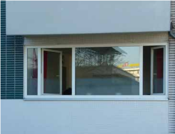
Lüftung „per Hand“: Im Winter am besten kurz, aber mit weit geöffnetem Fenster
