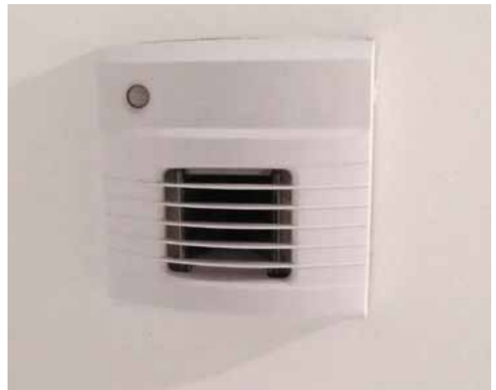
Abluftöffnung (Abführen „verbrauchter Luft“)
