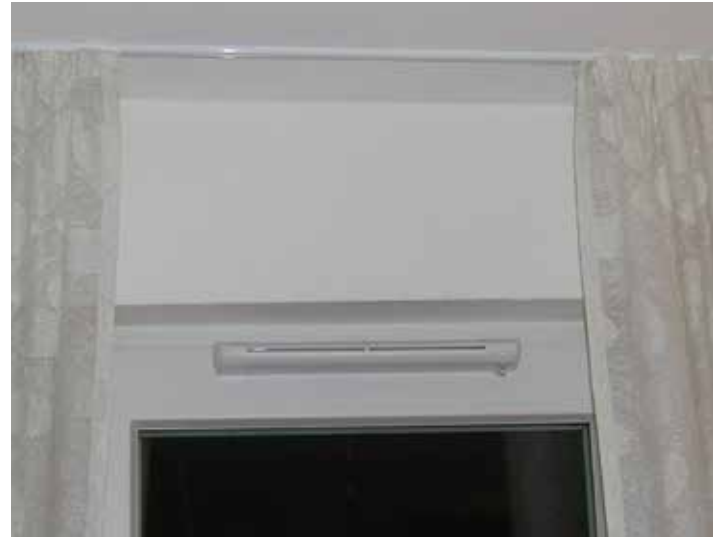
Lüftung mit Technik: Zuluftöffnung (Einströmen „frischer“ Luft) über dem Fenster
