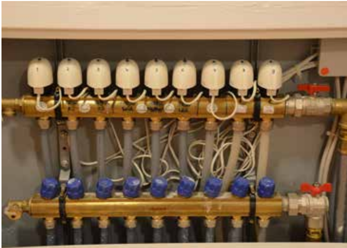
Heizkreisverteiler einer Fußbodenheizung: Die Temperatur kann raumweise geregelt werden.
