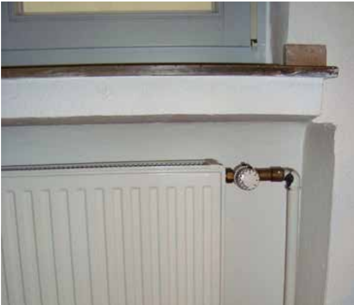
Häufig befinden sich Heizkörper in Wandnischen.
