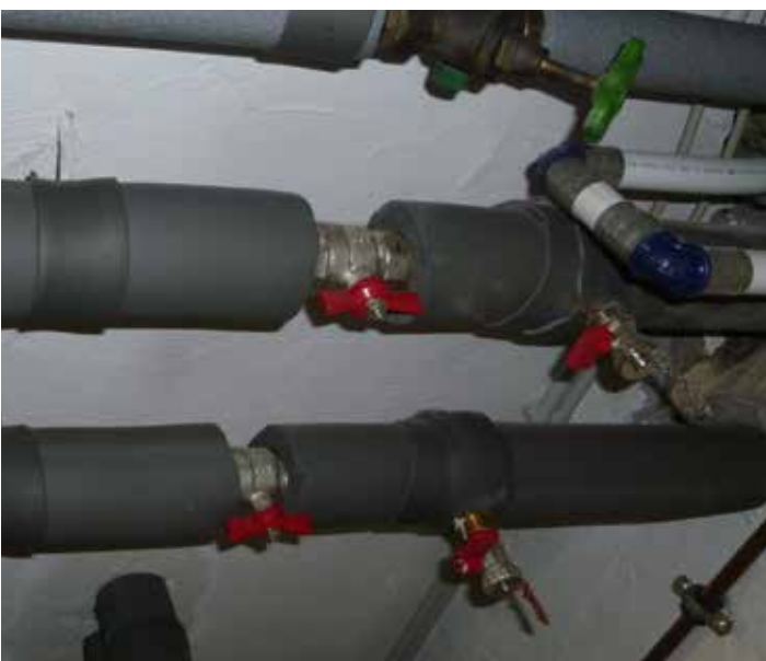
Gedämmte Heizungs- und Warmwasserrohre im Keller. Es fehlt hier die Dämmung der Armaturen.
