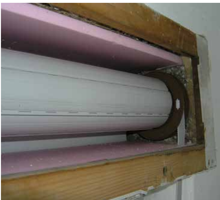
Nachträglich gedämmter Rollladenkasten
