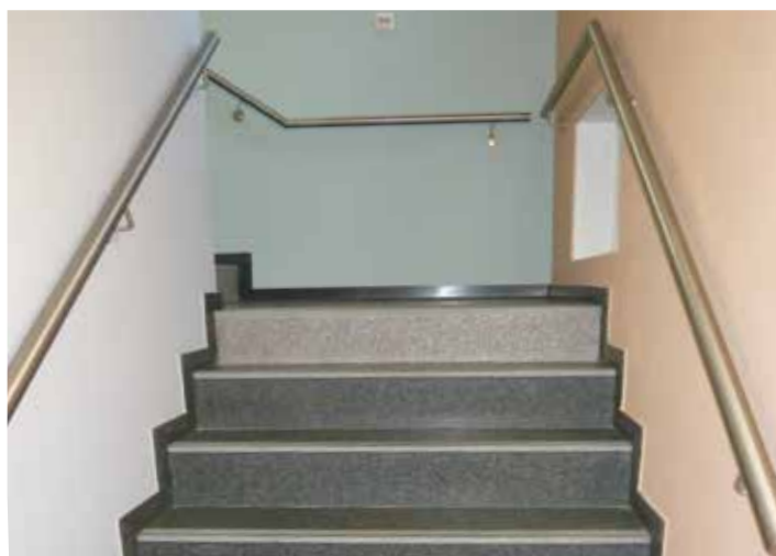
Vorbildlich ausgeführte Treppe in einem Seniorenwohnheim (Art und Anordnung der Handläufe, kontrastreiche Farbgestaltung)
