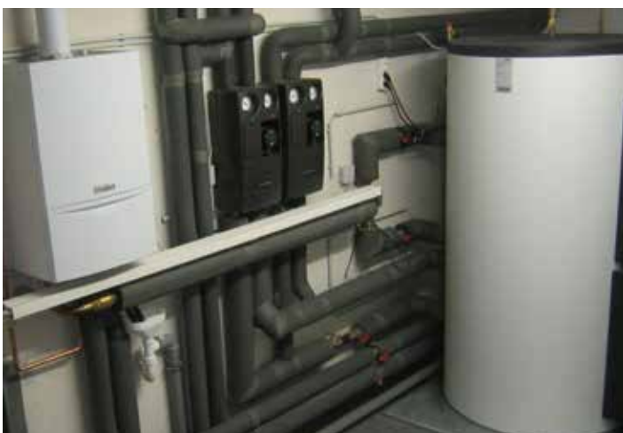
zentrale Warmwasserbereitung mit Wasserspeicher
