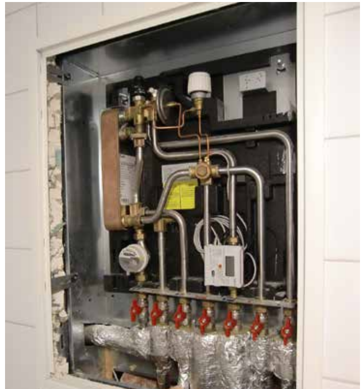
Frischwasserstation in der Wohnung eines Mehrfamilienhauses (hier ohne Abdeckung)
